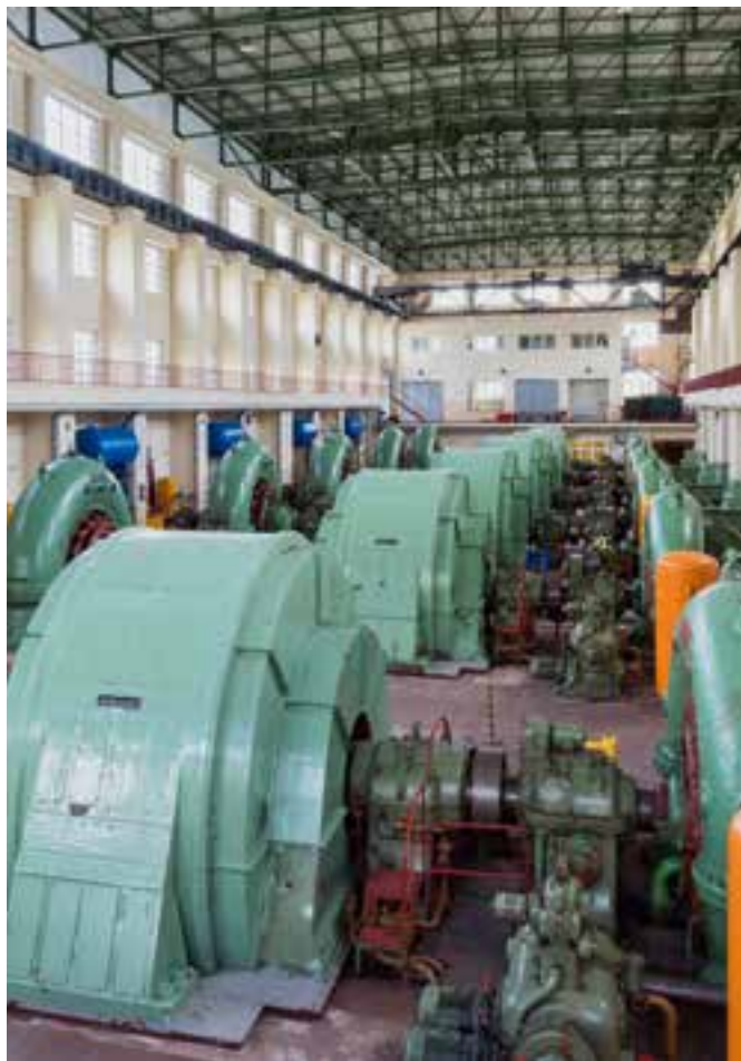
Inneres des Maschinenhauses mit Pumpspeichersätzen
